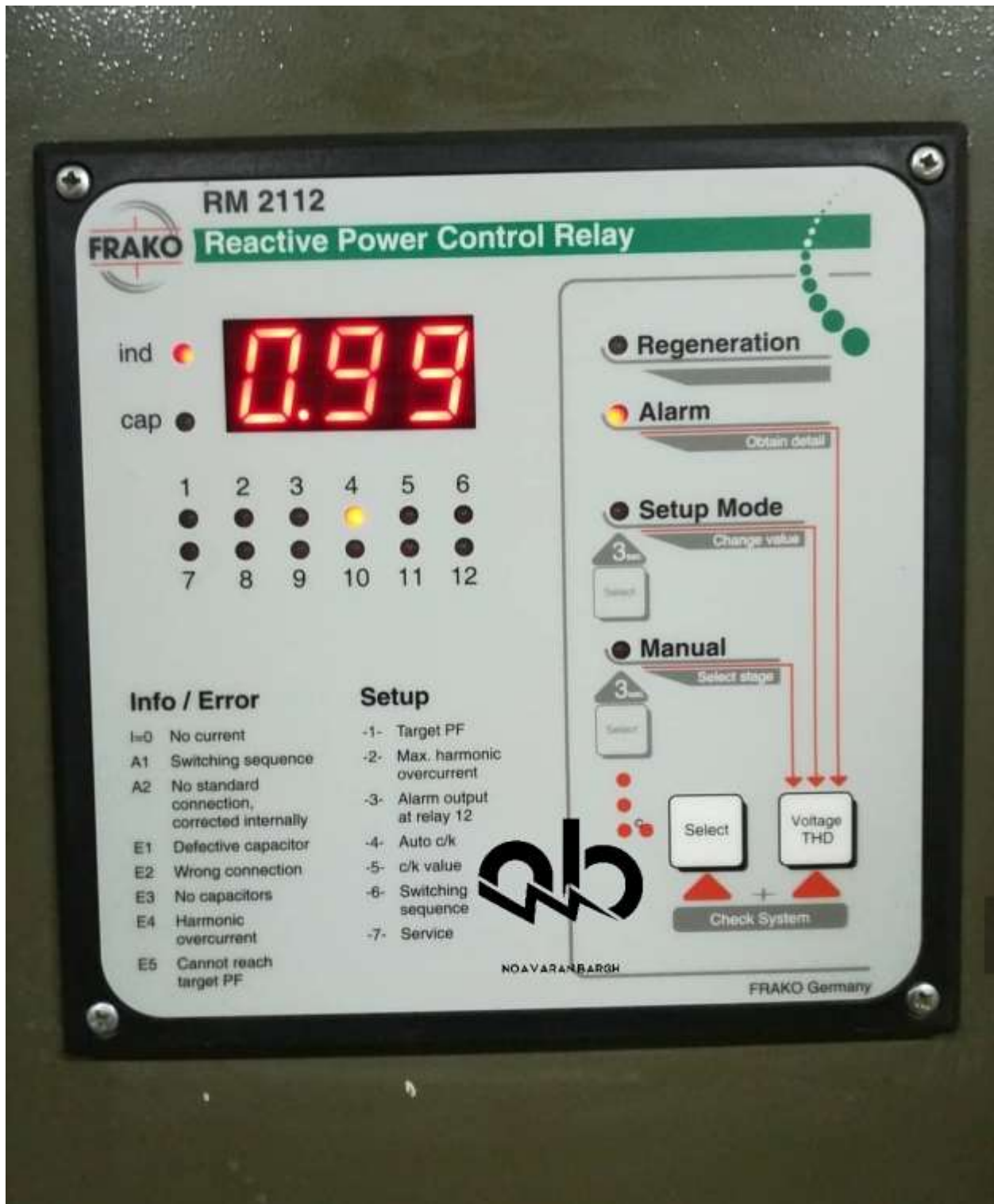
عیب یابی تابلو برق های صنعتی :
